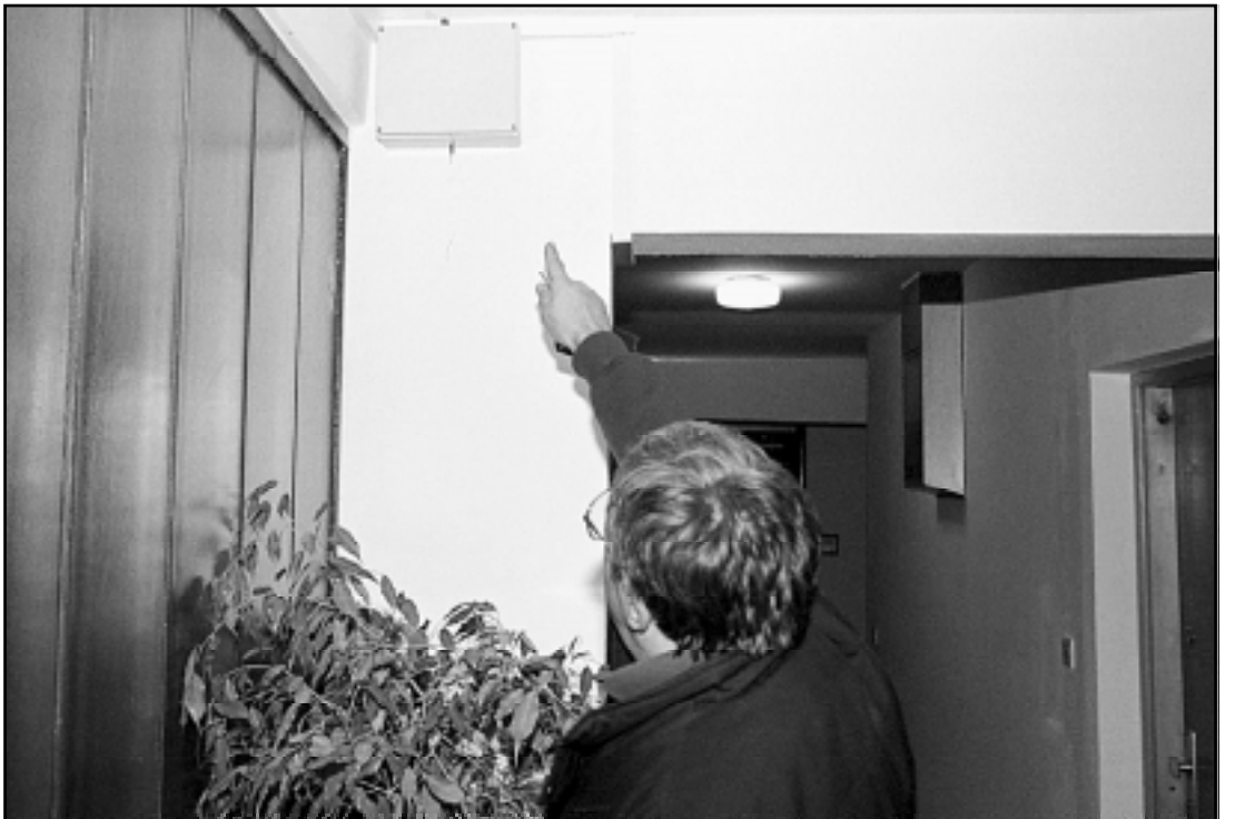
»Antena« navodno nelegalno uvodi nove instalacije koristeći telefonske žljebove
